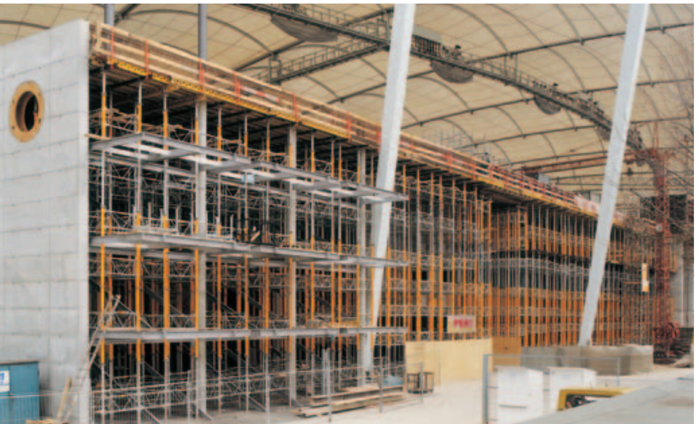
Reprise fiable de charges élevées: étaielement MULTIPROP, haut de 14,00 m, sur une surface de 3.500 m 2 .
