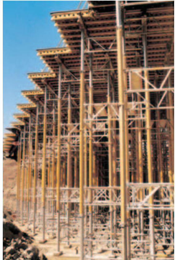
Tours MULTIPROP de 8,80 m de haut utilisées pour étayer des tables de coffrage.
